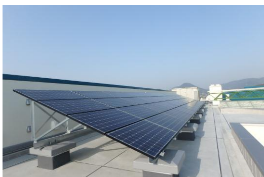
太陽光発電設備
