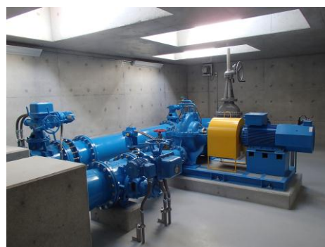
小水力発電設備
