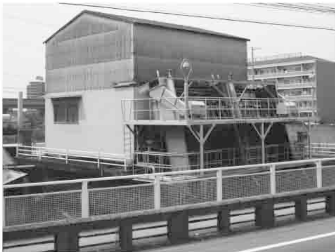
土器町にある産砂雨水排水ポンプ場
