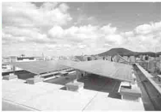
太陽光発電設備（消防庁舎）
