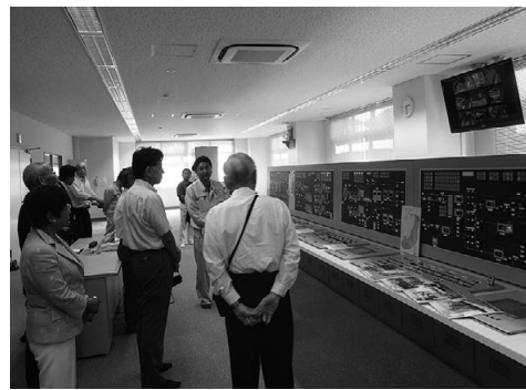
浄水場制御室
