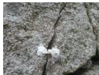
石垣亀裂箇所(ゲージ設置)
