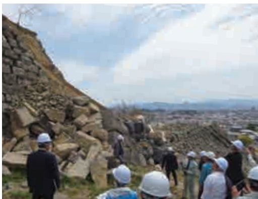
崩落現場の現状を確認
