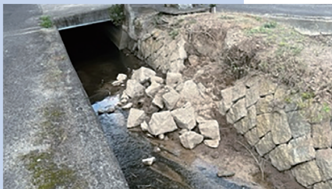
崩れたのり面 イノシシの仕業?!
