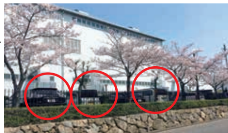
大手輸送機器メーカーへ納入した自社開発省エネルギー設備。
