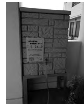
新設の雨水貯留槽
