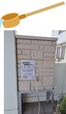
新設の雨水貯留槽
