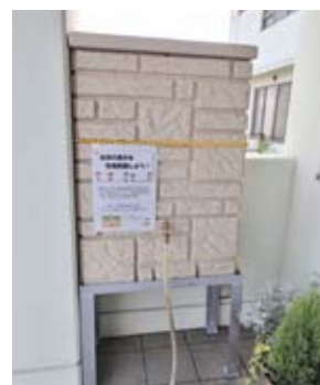
新設の雨水貯留槽
